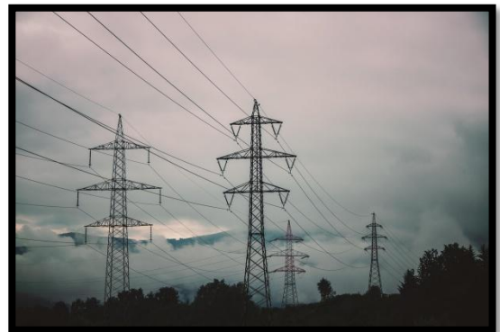
เสาไฟฟ้า
